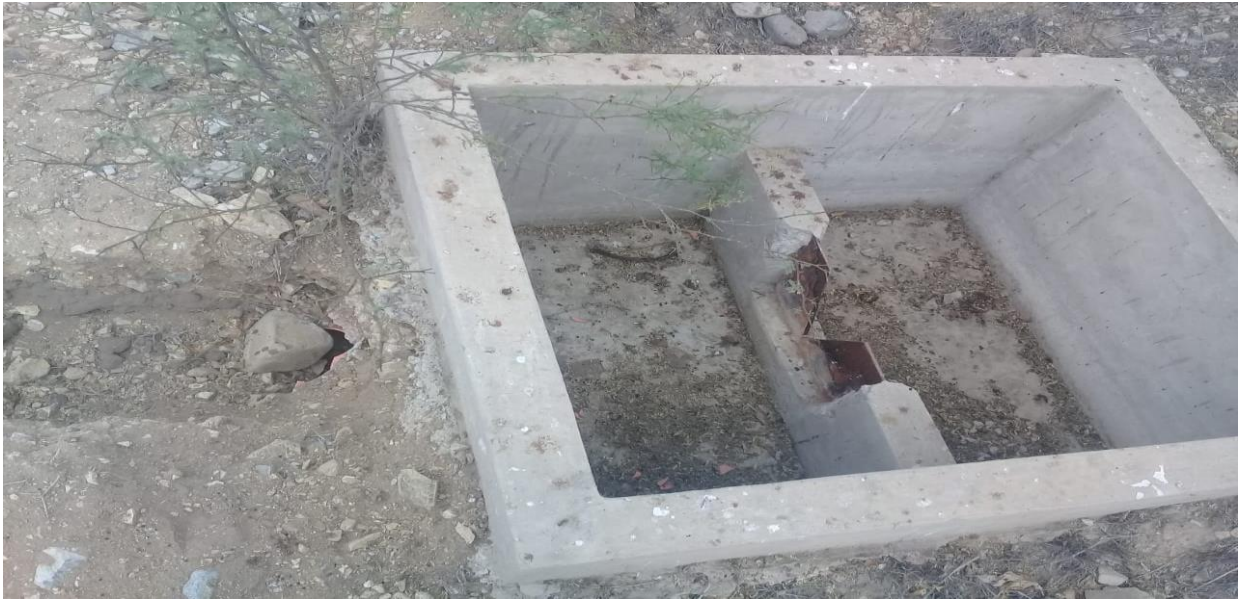
FIGURA 10: Vertedero en desuso y total abandono de la laguna número 4, con tubería rota y presencia de excreta de roedores.
