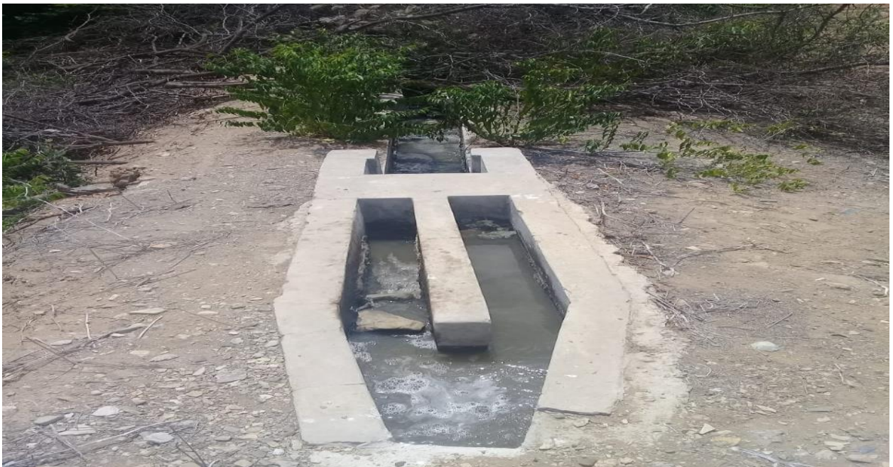
FIGURA 9: Fotografía del desarenador, en total estado de abandono, obstruido por piedras colocadas por personas ajenas al lugar, y cubierto de vegetación.
