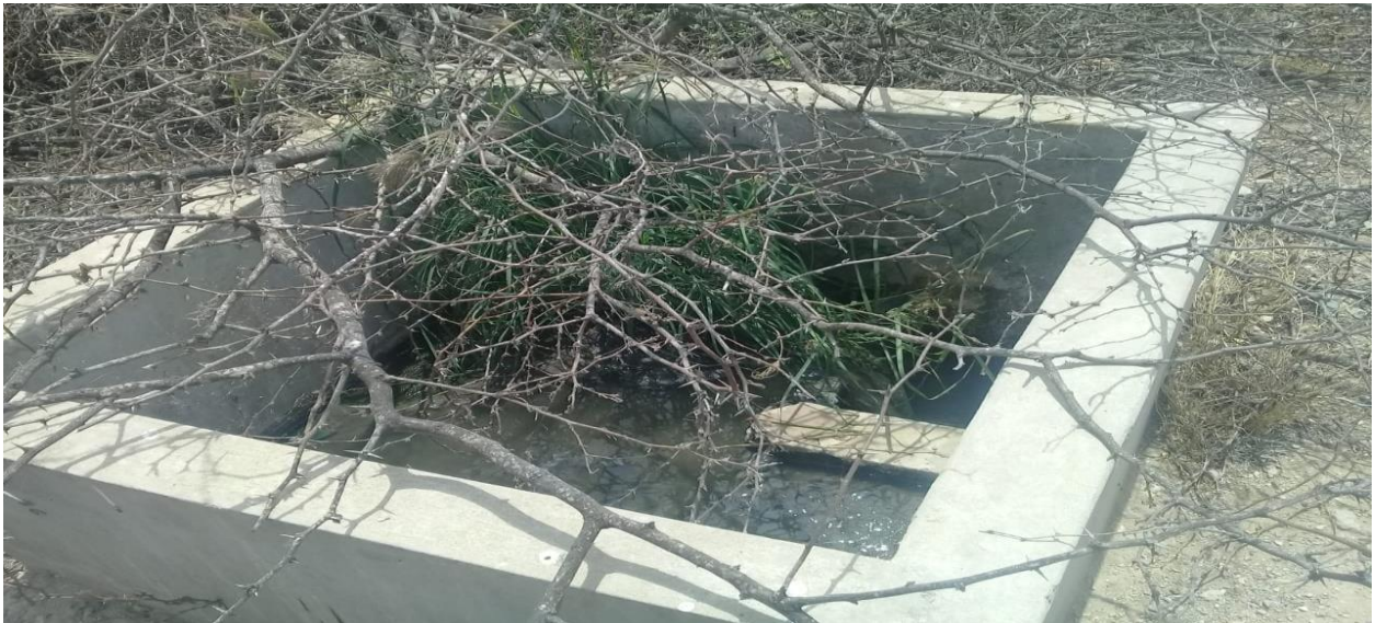
FIGURA 11: Fotografía de estructura de cabecera de laguna cubierta de vegetación y con alta presencia de lodos y piedras.
