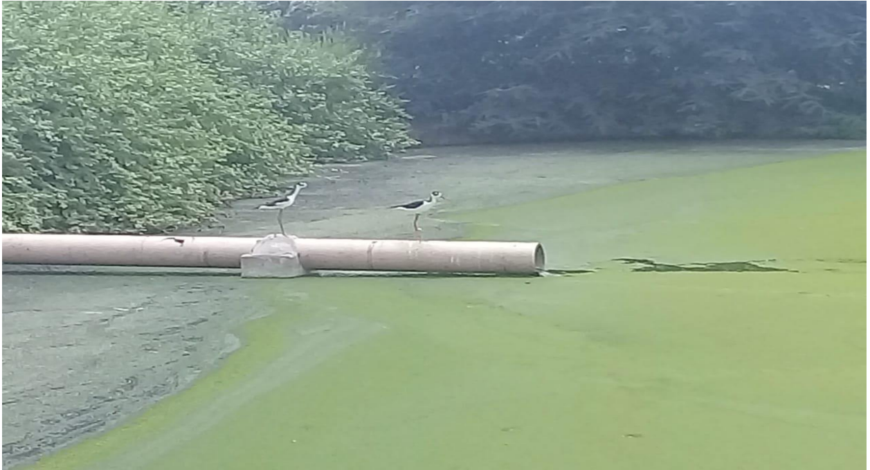
FIGURA 8: Presencia de aves en las lagunas de estabilización, se puede apreciar las excretas de las aves en la tubería y las costras formadas de color oscuro en la parte izquierda.
