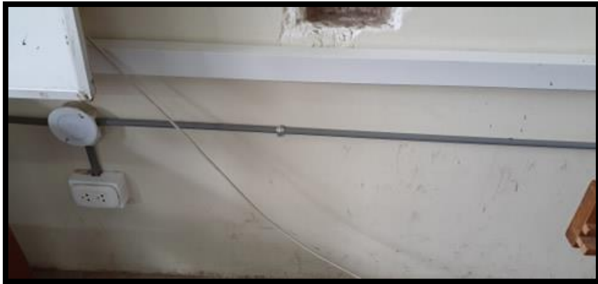
Figura 16. Los equipos informáticos están conectados a UPS
