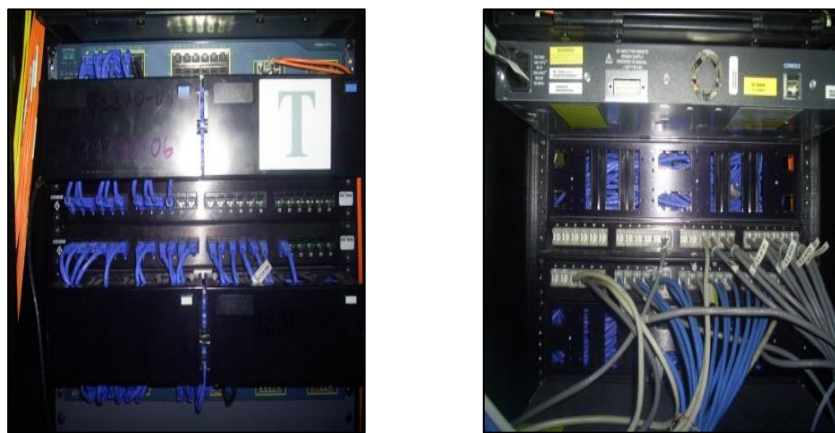
Figura 13. Marco de conexión principal de fibra óptica
