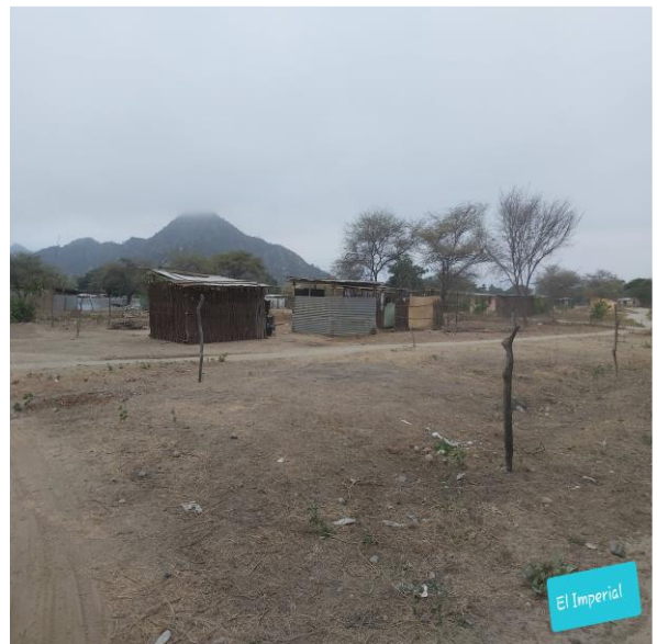
Fotografía N° 4 - Identificación de estado de conservación en viviendas
